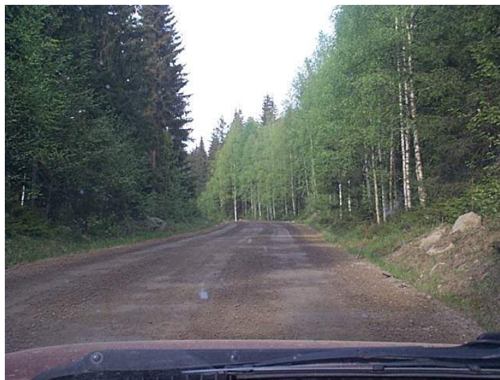
Kuva 1: Peruskorjattava, routavaurioitunut tie keväällä 2002. Luopioinen
