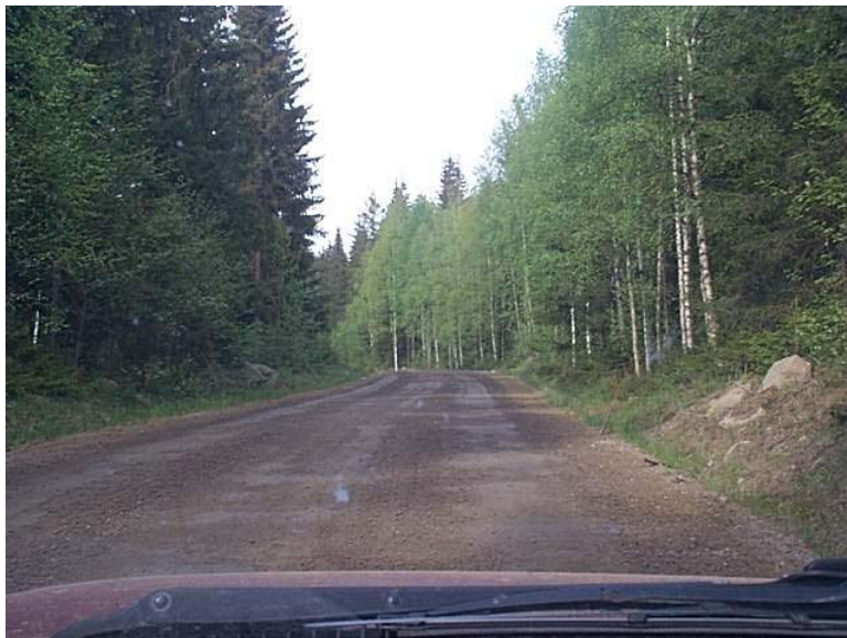
Kuva 1. Peruskorjattava, routavaurioitunut tie keväällä 2002. Luopioinen.
